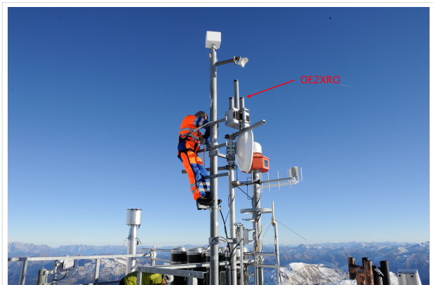
Blick auf die Bake OE2XRO mit 3 Antennen
