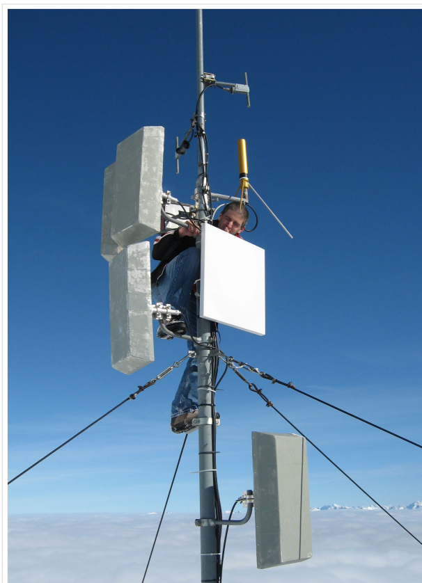
Antennenanlage OE7XGR, OE7FMI im Oktober 2009
