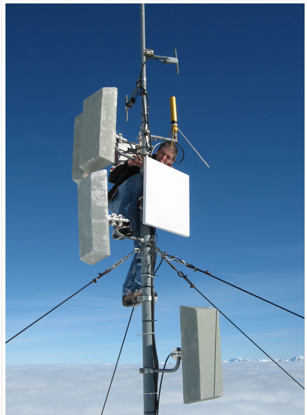
Antennenanlage OE7XGR, OE7FMI im Oktober 2009
