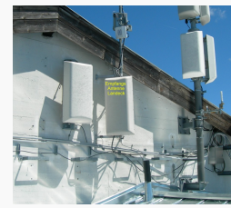
Empfangsantenne Richtung Landeck
