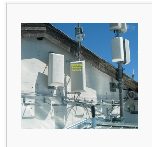
Empfangsantenne Richtung Landeck
