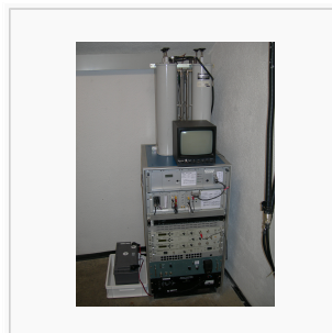
Geräteschrank ATV, darunter OE7XTR 145,775
