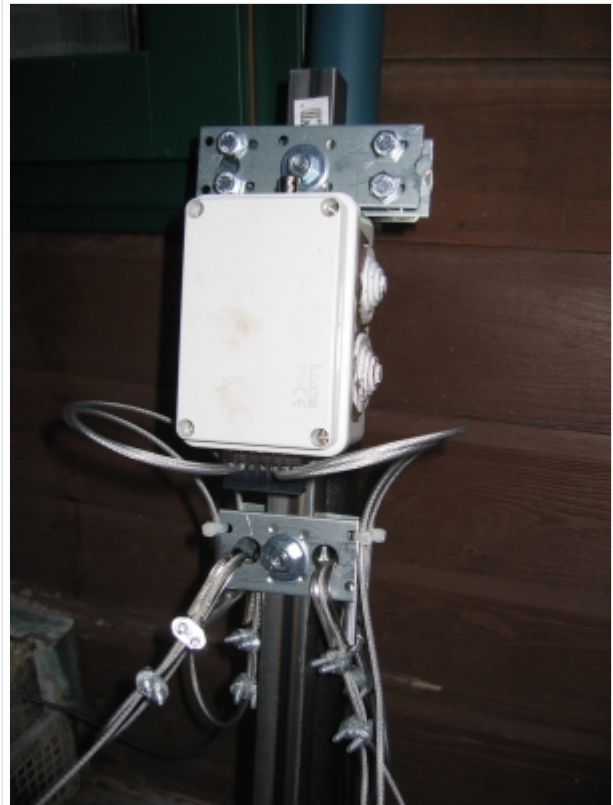
Transformator im geschlossenen Gehäuse
