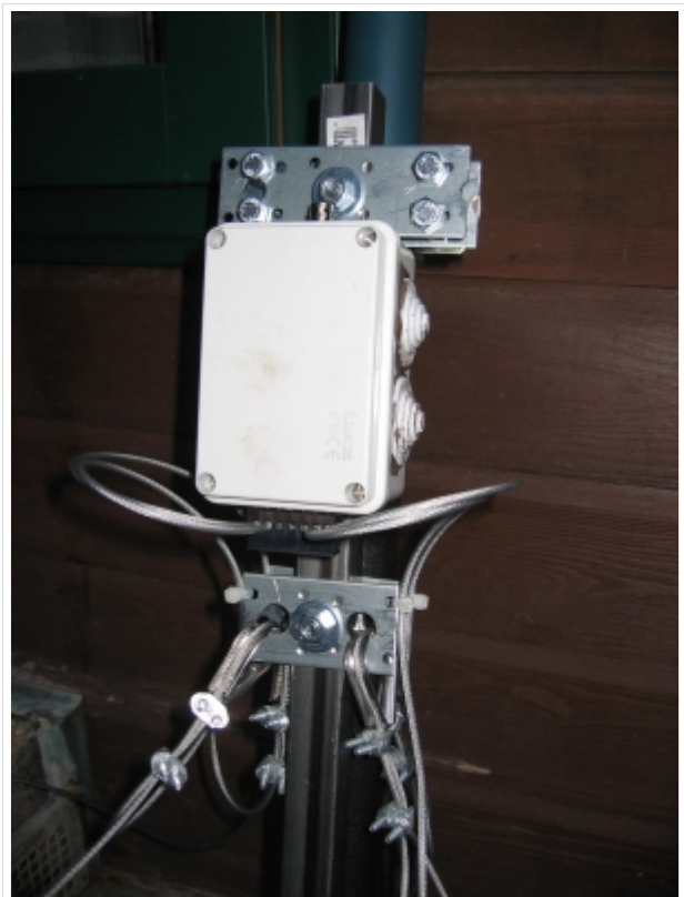
Transformator im geschlossenen Gehäuse
