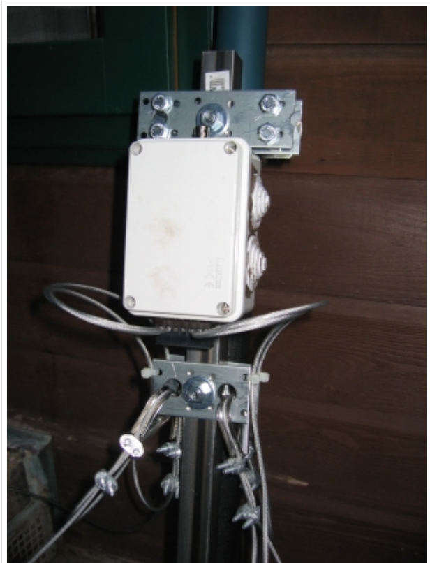
Transformator im geschlossenen Gehäuse
