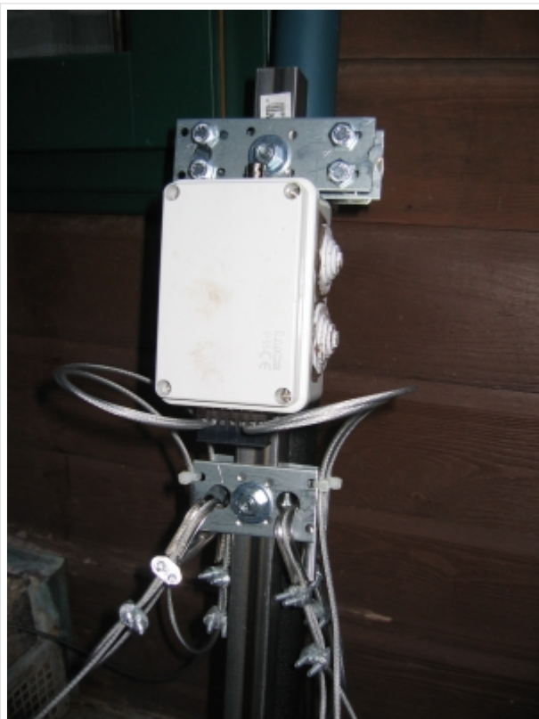
Transformator im geschlossenen Gehäuse
