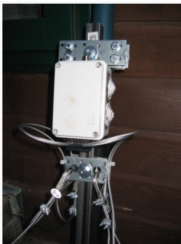
Transformator im geschlossenen Gehäuse
