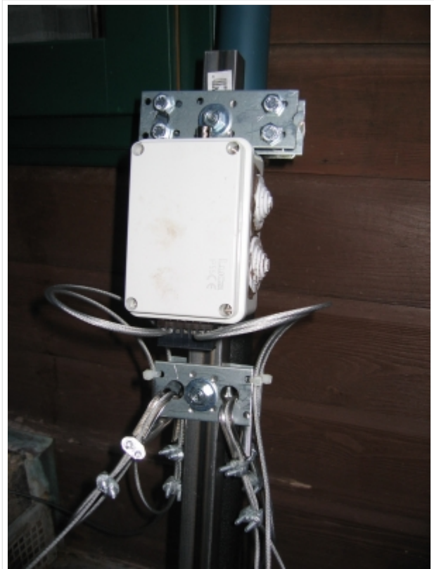
Transformator im geschlossenen Gehäuse
