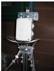
Transformator im geschlossenen Gehäuse
