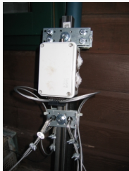
OE1IFM Transformator im geschlossenen Gehäuse
