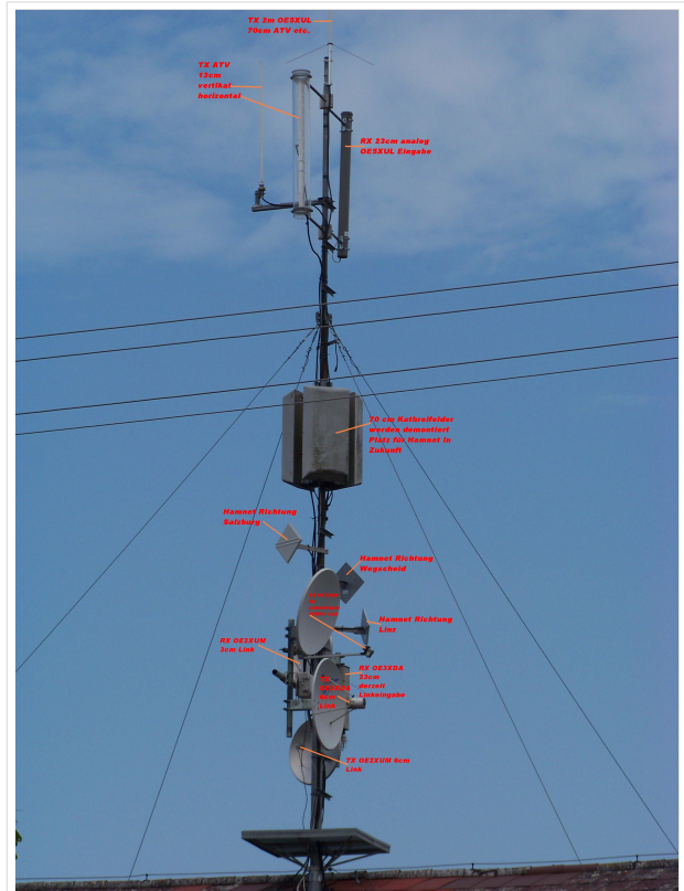
Bild der Antennenanlage
