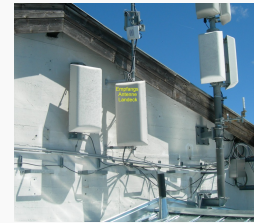
Empfangsantenne Richtung Landeck
