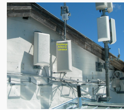
Empfangsantenne Richtung Landeck
