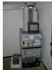
Geräteschrank ATV, darunter OE7XTR 145,775
