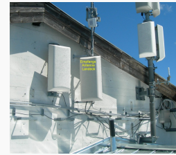
Empfangsantenne Richtung Landeck
