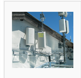
Empfangsantenne Richtung Landeck
