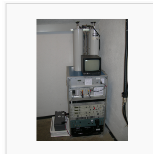
Geräteschrank ATV, darunter OE7XTR 145,775
