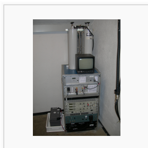
Geräteschrank ATV, darunter OE7XTR 145,775
