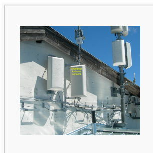
Empfangsantenne Richtung Landeck
