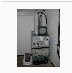
Geräteschrank ATV, darunter OE7XTR 145,775
