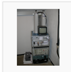
Geräteschrank ATV, darunter OE7XTR 145,775
