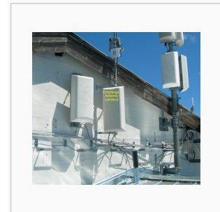
Empfangsantenne Richtung Landeck
