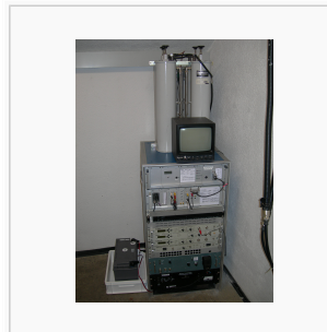
Geräteschrank ATV, darunter OE7XTR 145,775
