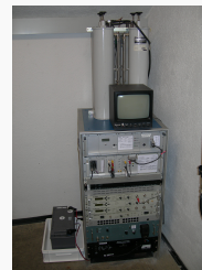
Geräteschrank ATV, darunter OE7XTR 145,775
