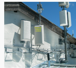
Empfangsantenne Richtung Landeck
