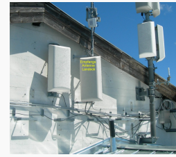
Empfangsantenne Richtung Landeck
