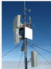
Antennenanlage OE7XGR, OE7FMI im Oktober 2009
