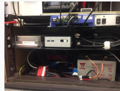
Rack inkl. HAMNET- Einschub, MeanWell AD155A, IntelNUC und PowerPole-Verteiler
