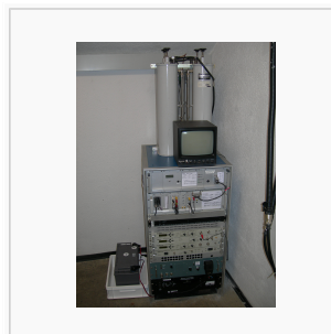
Geräteschrank ATV, darunter OE7XTR 145,775
