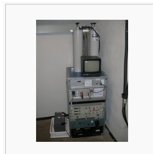
Geräteschrank ATV, darunter OE7XTR 145,775
