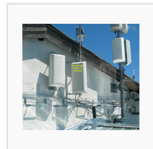
Empfangsantenne Richtung Landeck
