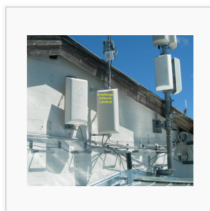
Empfangsantenne Richtung Landeck
