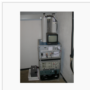
Geräteschrank ATV, darunter OE7XTR 145,775
