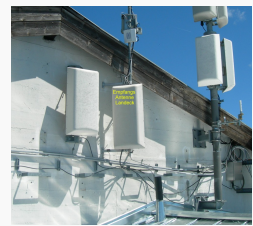
Empfangsantenne Richtung Landeck
