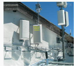
Empfangsantenne Richtung Landeck
