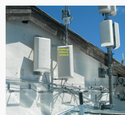
Empfangsantenne Richtung Landeck
