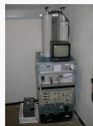
Geräteschrank ATV, darunter OE7XTR 145,775
