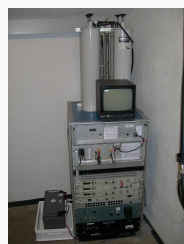
Geräteschrank ATV, darunter OE7XTR 145,775
