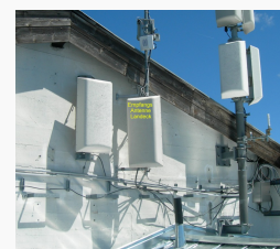
Empfangsantenne Richtung Landeck
