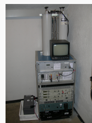
Geräteschrank ATV, darunter OE7XTR 145,775
