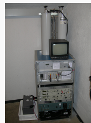
Geräteschrank ATV, darunter OE7XTR 145,775
