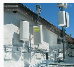
Empfangsantenne Richtung Landeck
