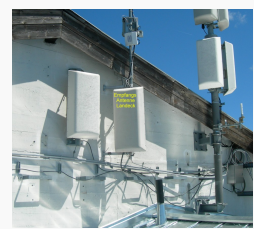
Empfangsantenne Richtung Landeck
