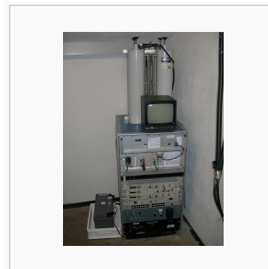
Geräteschrank ATV, darunter OE7XTR 145,775
