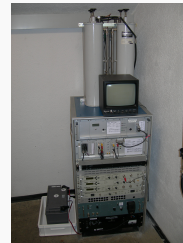
Geräteschrank ATV, darunter OE7XTR 145,775
