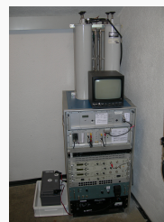
Geräteschrank ATV, darunter OE7XTR 145,775
