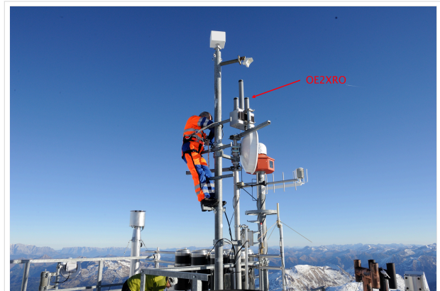
Blick auf die Bake OE2XRO mit 3 Antennen
