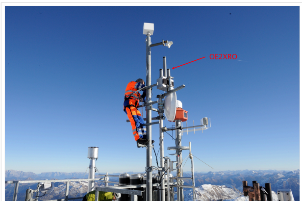
Blick auf die Bake OE2XRO mit 3 Antennen
