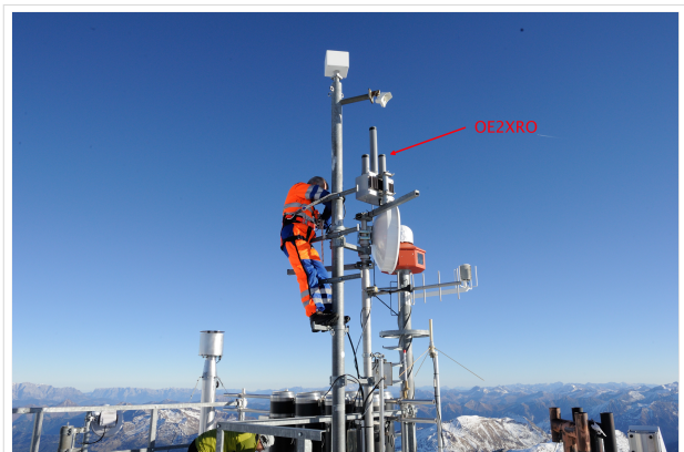
Blick auf die Bake OE2XRO mit 3 Antennen
