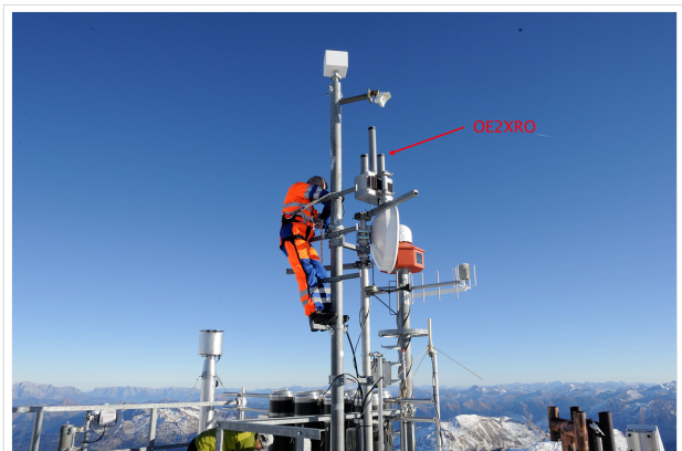
Blick auf die Bake OE2XRO mit 3 Antennen
